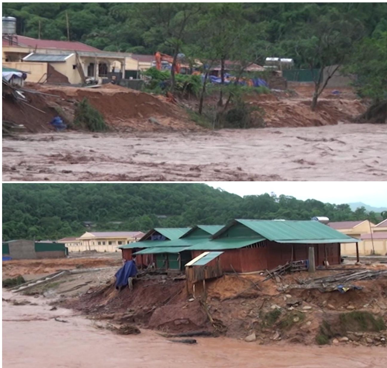
Hình 2- 13: Hiện trạng sạt lở đất do lũ gây ra trên dòng sông Nậm Pồ, đoạn qua trung tâm huyện
