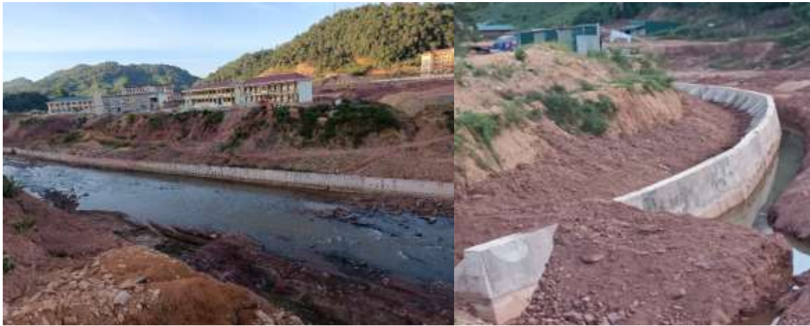
Hình 2- 6: Một đoạn kè Nậm Pồ trong thời gian xây dựng và hoàn thành
