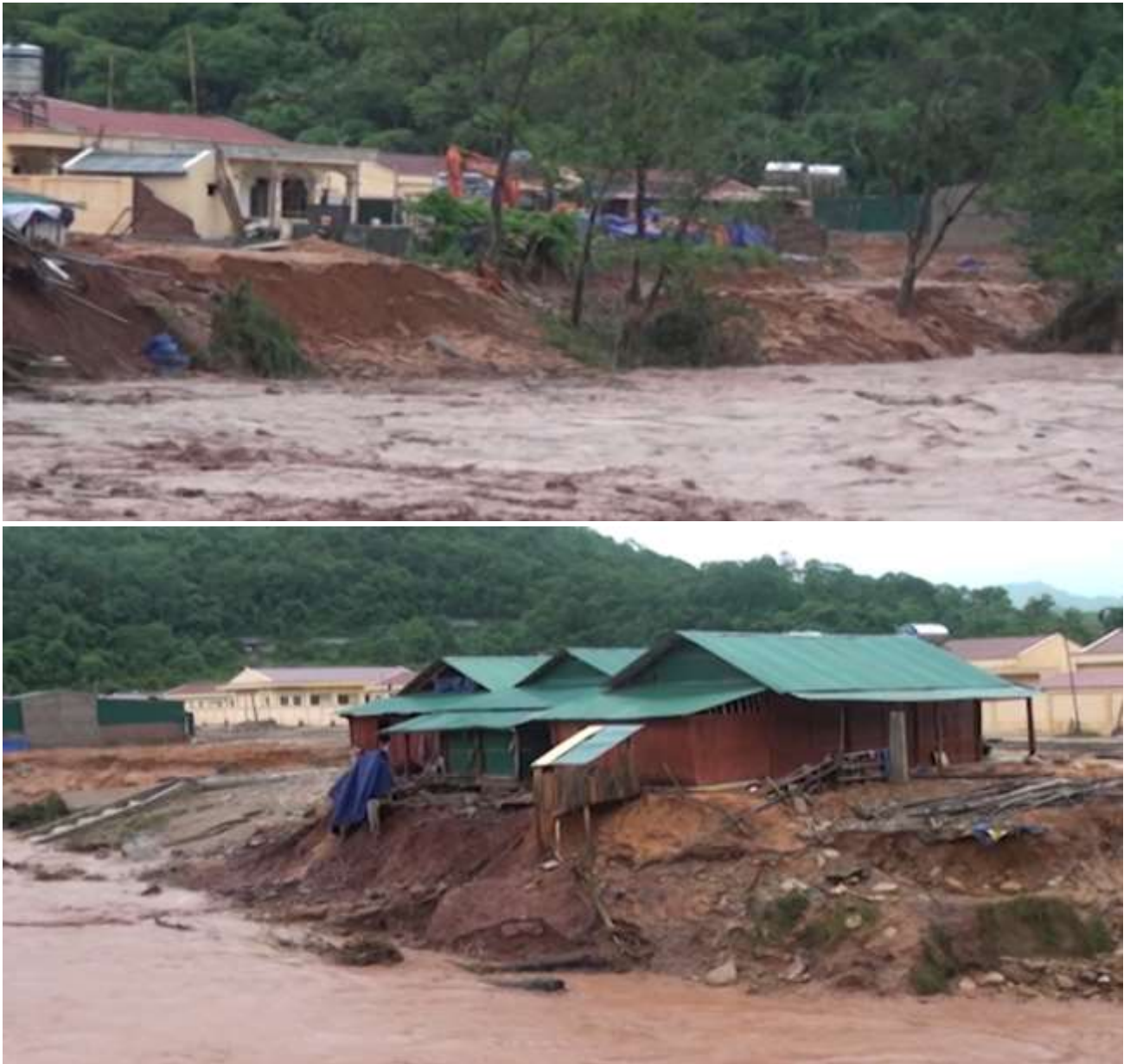
Hình 2- 10: Hiện trạng sạt lở đất do lũ gây ra trên dòng sông Nậm Pồ, đoạn qua trung tâm huyện
